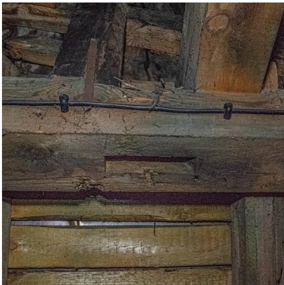
Figure 10 Znaczące osłabienie przekroju poprzecznego płatwi spowodowane czopem po brakującym elemencie wspornym (fot. M. Wac)
