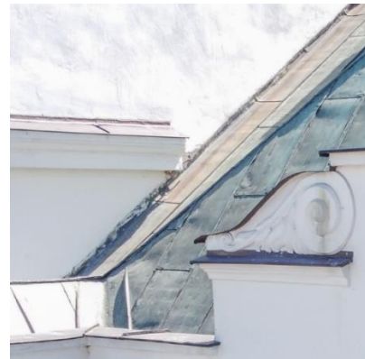
Figure 5 Zniszczenie i rozszczelnienie połączenia połaci ze ścianą sąsiedniego budynku spowodowane niewykonaniem odpowiedniego rodzaju obróbki (fot. M. Wac)
