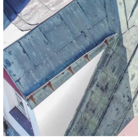
Figure 7 Elementy montażowe pokrycie z poszyciem powodujące rdzawe zacieki na połaciach (fot. M. Wac)
