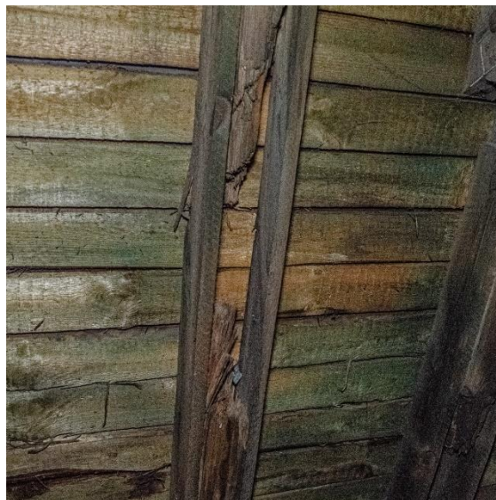
Figure 11 Całkowite zdegradowanie krokwi, widoczna próba częściowej naprawy i wzmocnienia elementu (fot. M. Wac)
